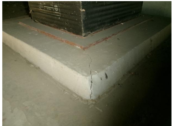
A1-SH5 받침몰탈 균열(0.1mm/0.1m)
