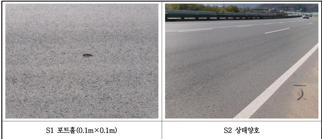
【사진 1.3.18】 교면포장 손상현황
