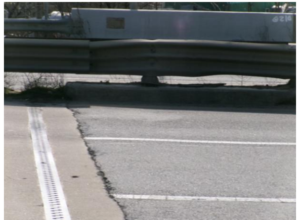
S1 중앙분리대 가드레일 지주파손, 변형
