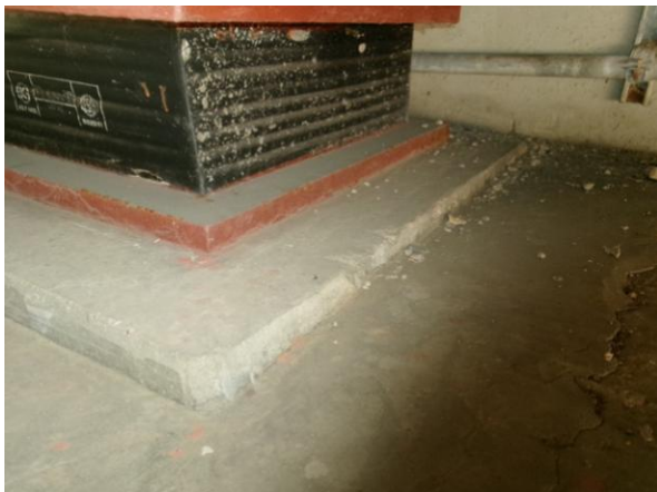
A1-SH7 받침몰탈 파손(0.1m×0.1m)
